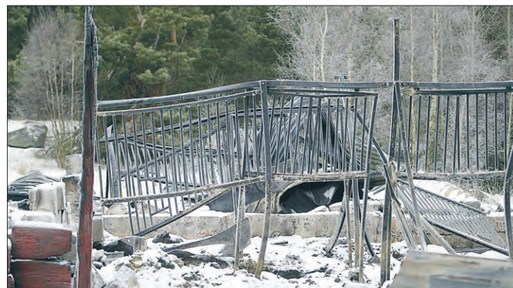
Utredningen har visat att branden orsakades av en trasig elkabel. 14 hästar brann inne.
